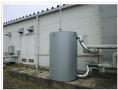
冷却ポンプの省エネ効果を狙う冷水タンク
