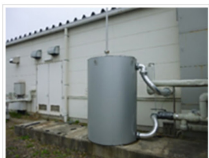
冷却ポンプの省エネ効果を狙う冷水タンク
