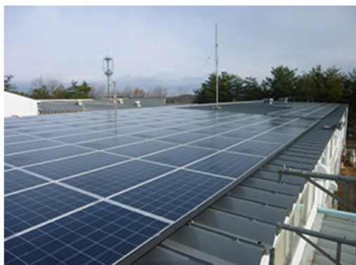
福島工場の太陽光発電パネル
