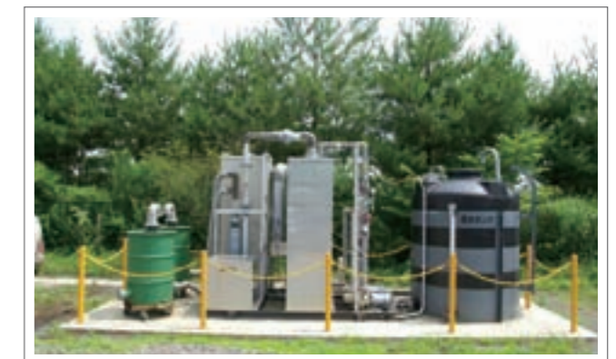
地下水浄化装置
