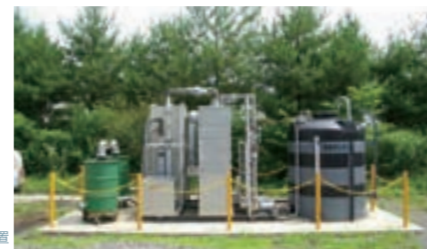
地下水浄化装置
