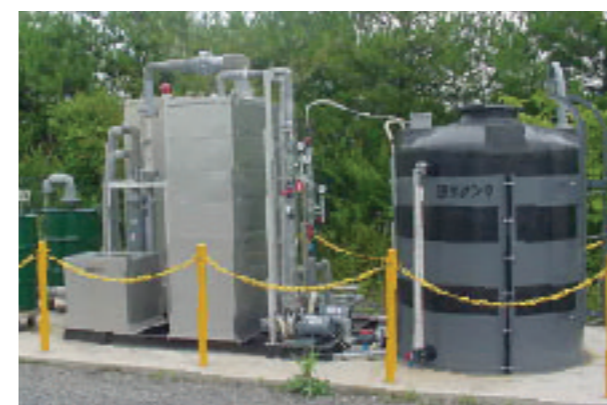
地下水浄化装置
