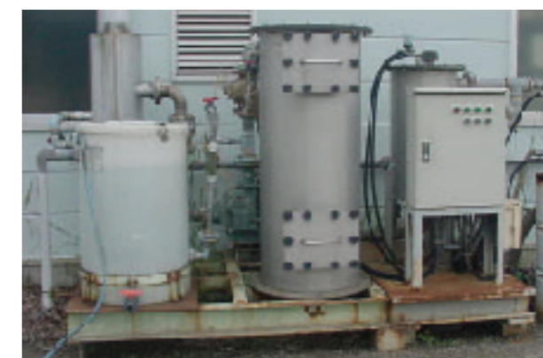
土壌浄化装置
